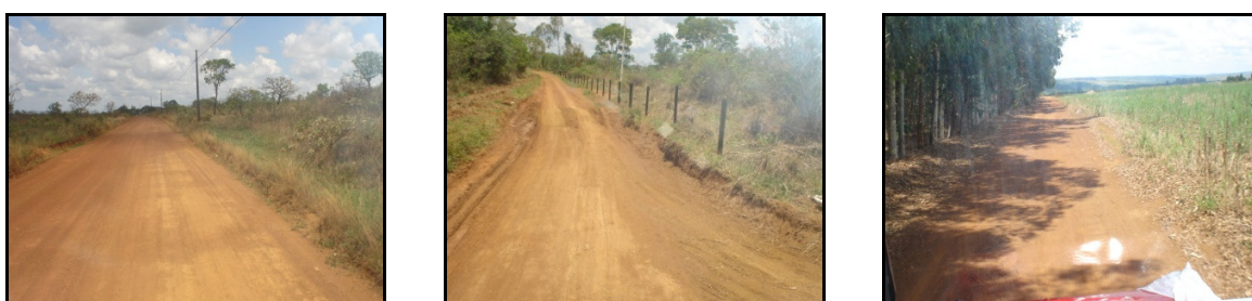
Figura 6.7: Estado de conservação das estradas pesquisadas
