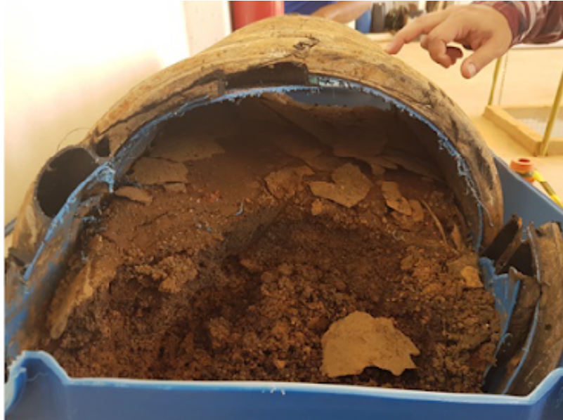
Figura 27 - Tubulação de drenagem de percolado obstruída do ASB.
