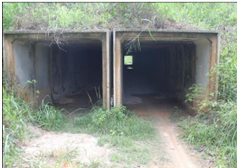
Figura 5 - Passagem de fauna subterrânea na BR-101/NE na Paraíba. Fonte: DNIT, 2017
