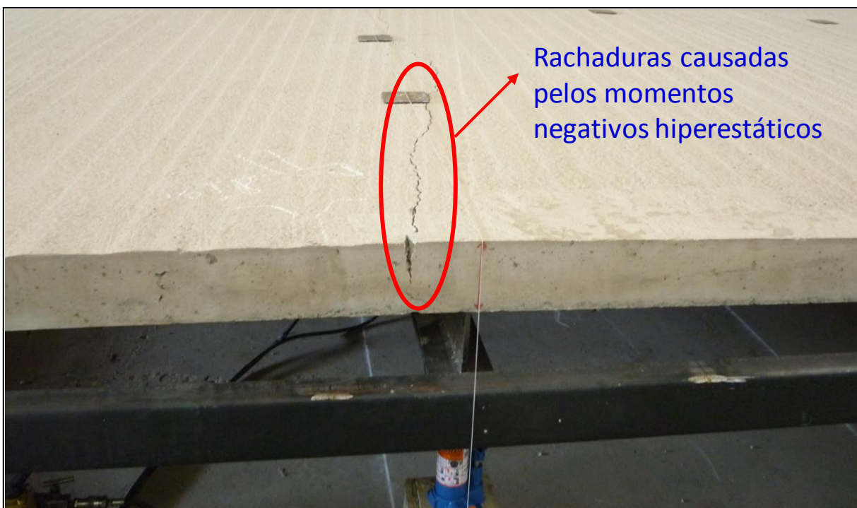
Figura Anexo II.10 – Fissuras apresentadas na laje pelos momentos negativos hiperestáticos.
