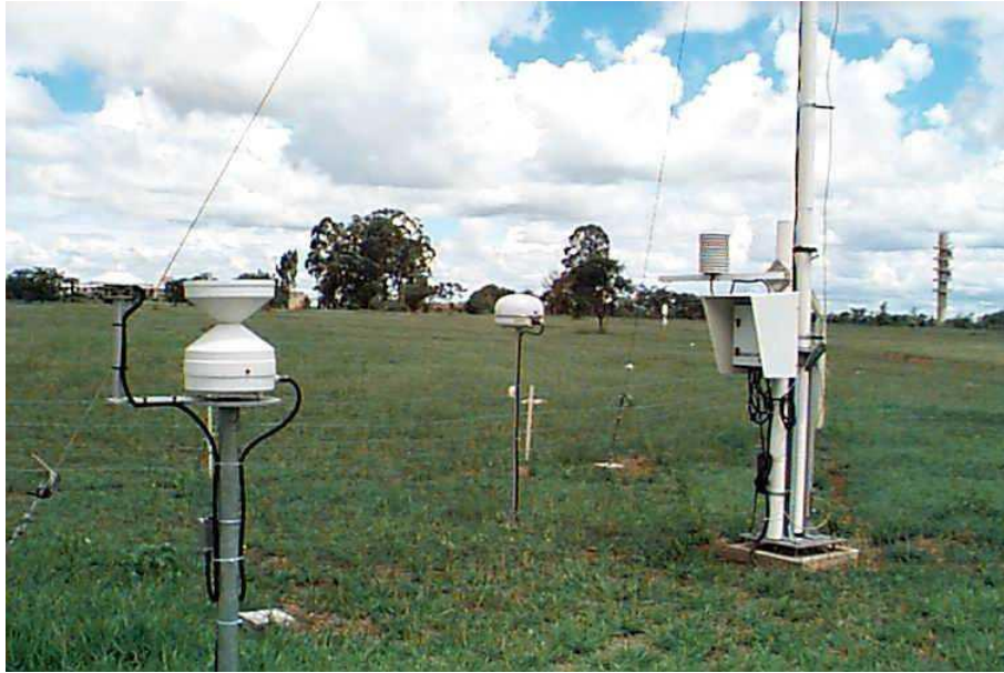
Figura 3-12: Detalhe de uma Estação Meteorológica Automática de superfície ( EMAS ), mostrando à esquerda o pluviômetro, ao centro a antena de comunicação via satélite e à direita o “datalogger” com sensor de temperatura, fixados ao mastro.
